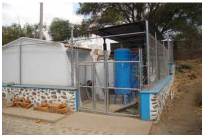
Planta Potabilizadora Municipio de Tuxcueca
