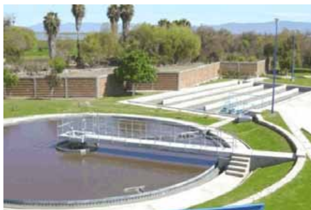
Planta de Tratamiento en Chapala
