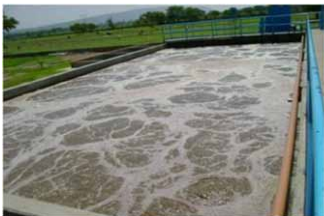
Reactor Biológico de la Planta
