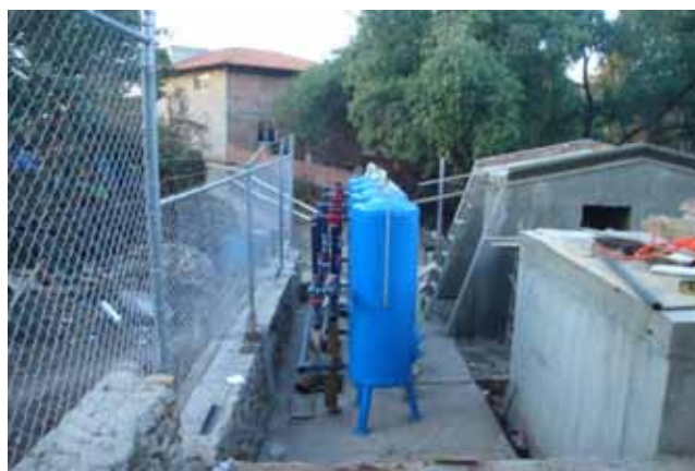
Planta Potabilizadora Municipio de Tuxcueca
