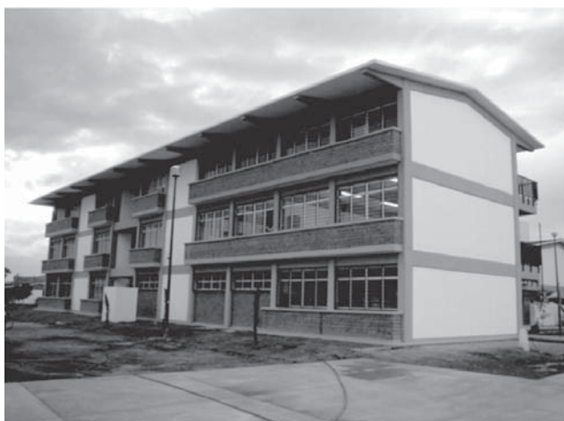
Tala, los Ruiseñores, Primaria Nueva Creación, 14DPR4105V Construcción de 13 aulas didácticas, núcleo de servicios sanitarios, bodega, intendencia, escaleras y obra exterior.
