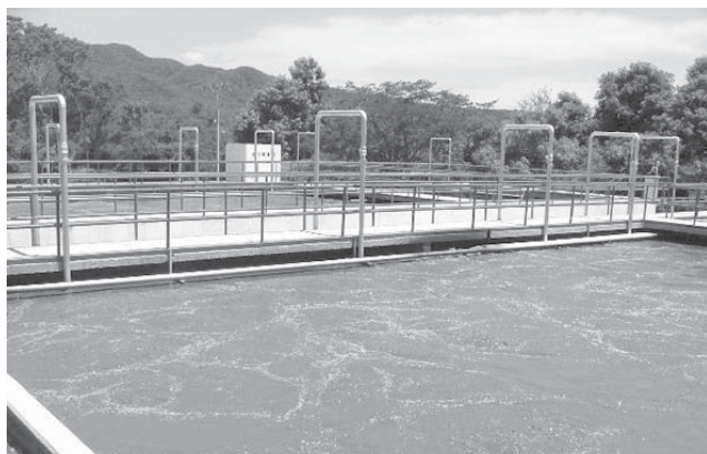
Planta de tratamiento en operación
