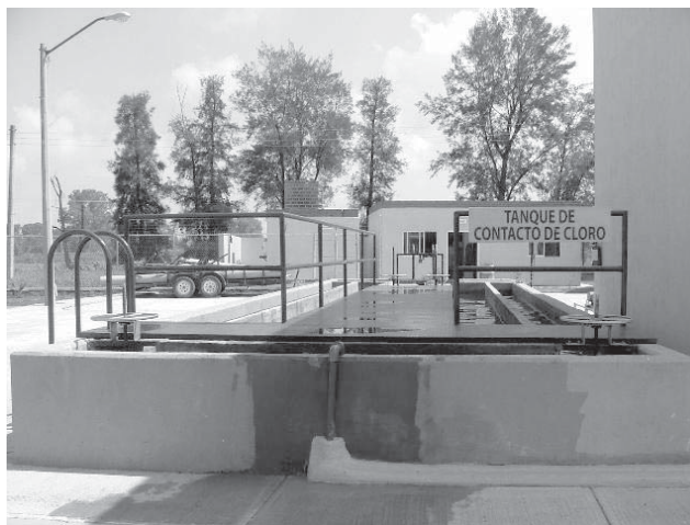
Tanque de contacto de Cloro
