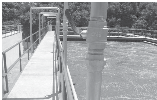
Planta de tratamiento en operación
