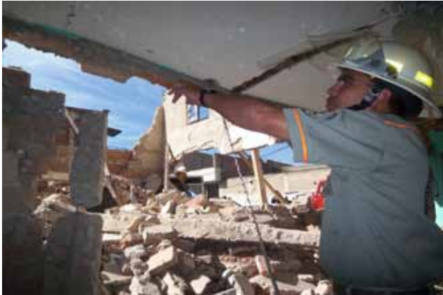
Análisis de daño estructural en construcciones afectadas por fenómenos perturbadores
