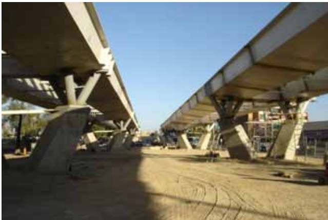
Avance de la construcción del puente vehicular Matute Remus, cruce de Av. Lázaro Cárdenas y Av. López Mateos.
