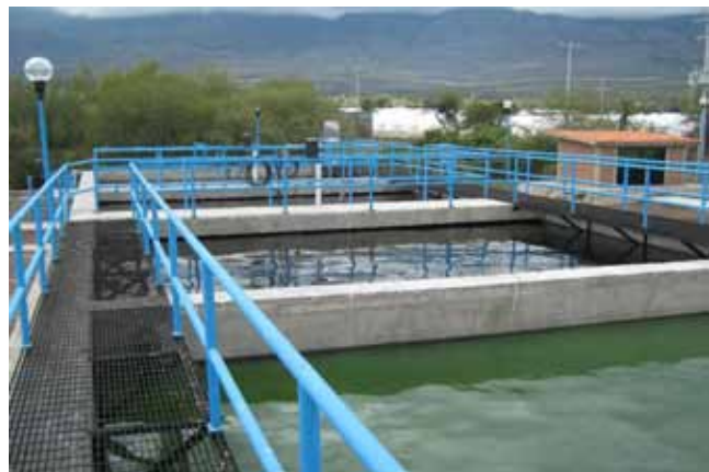
Planta de Tratamiento de Aguas Residuales en Amacueca
