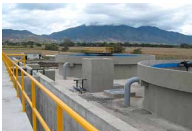
Clarificadores de la planta
