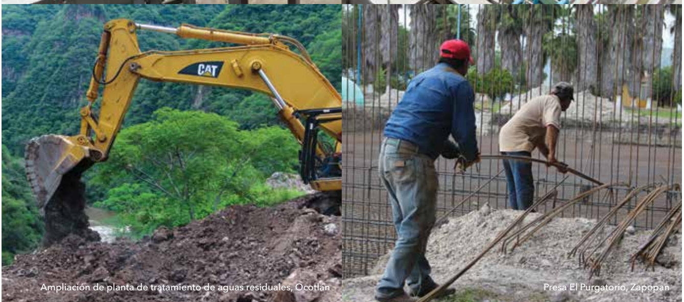
Planta de tratamiento de aguas residuales Agua Prieta, Zapopan
