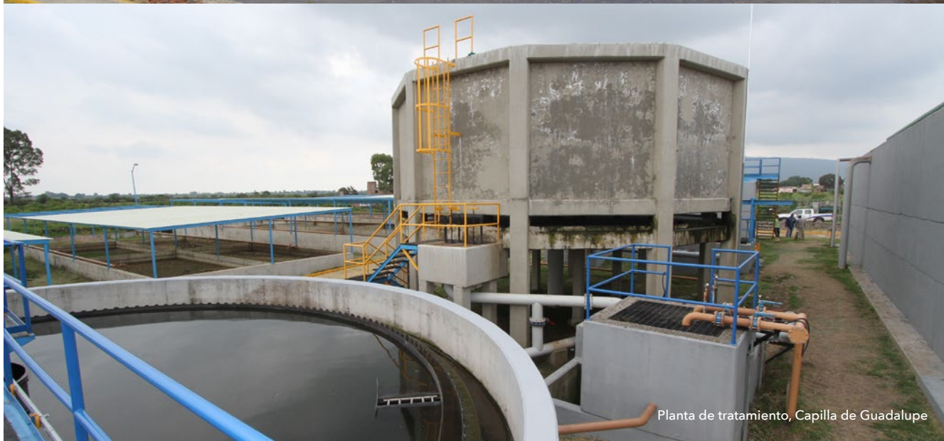
Planta de tratamiento, Ocotlán
