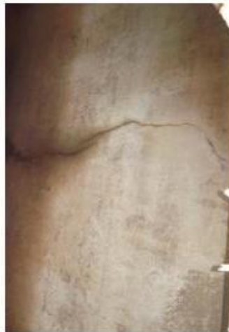
VISTA INTERIOR DONDE SE APRECA LA GREIJA EN EL TANQUE.
