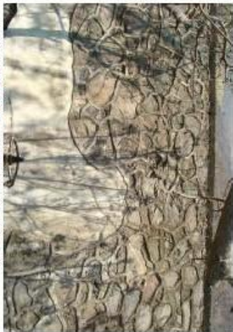
VISTA EXTERIOR DEL TANQUE DONDE SE FUGA EL AGUA.
