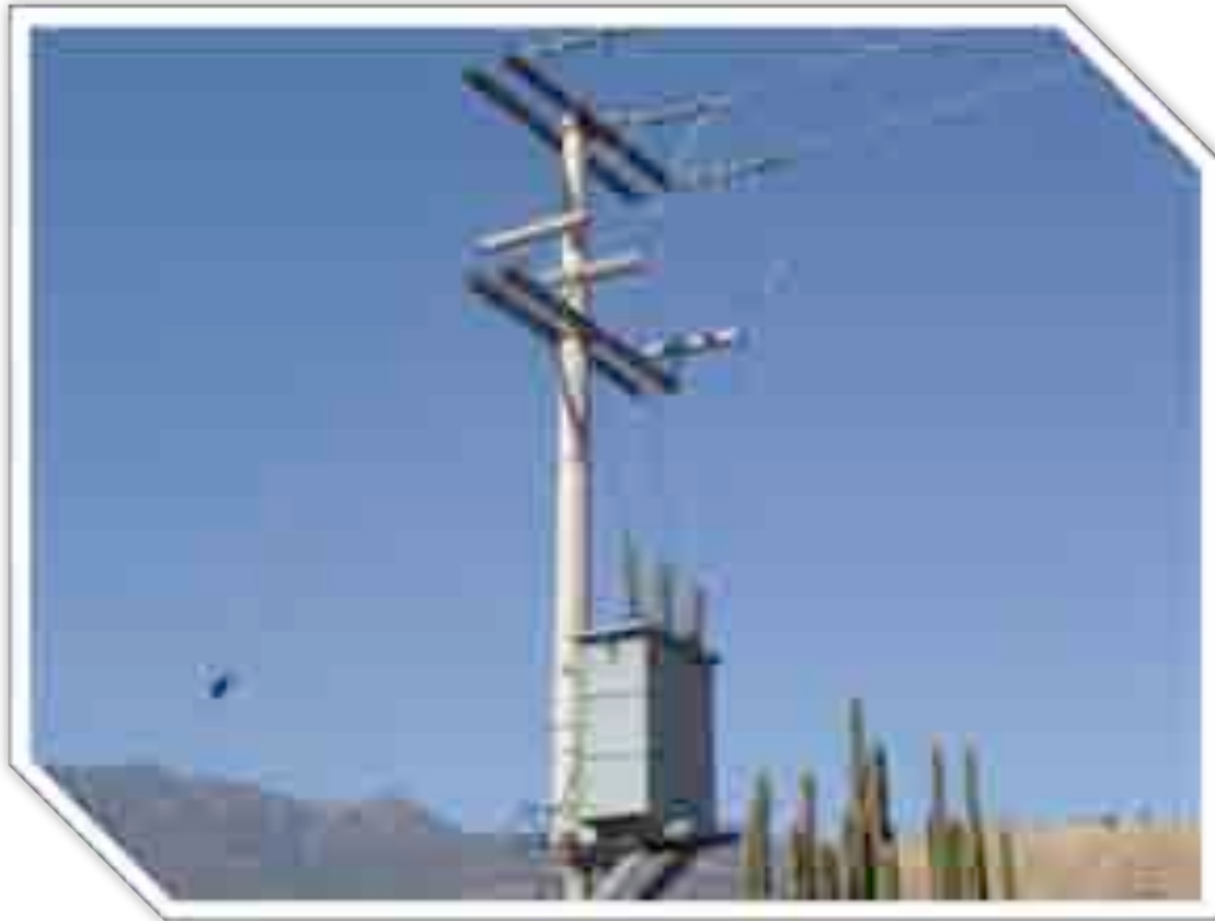
Imágen 1: Transformador de la Red Eléctrica Municipal.
