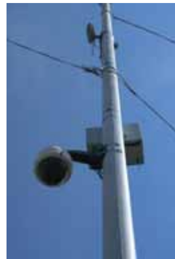
Cámaras de vigilancia
