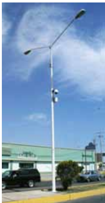
Cámaras de seguridad
