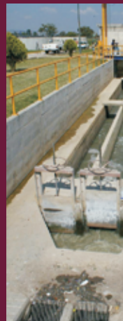
Planta de tratamiento de aguas negras
