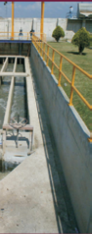
Tratamiento de aguas
