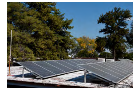
Paneles Solares en la Escuela Normal Rural de Atequiza, Ixtlahuacán de los Membrillos
